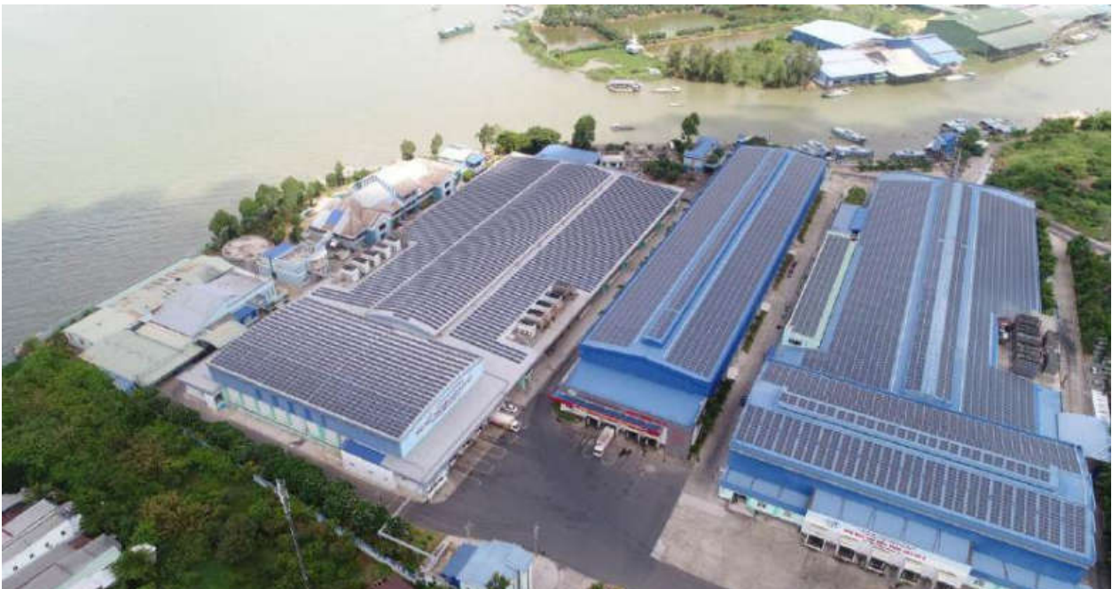
Hệ thống điện mặt trời trên nóc Nhà máy đông lạnh thủy sản IDI
