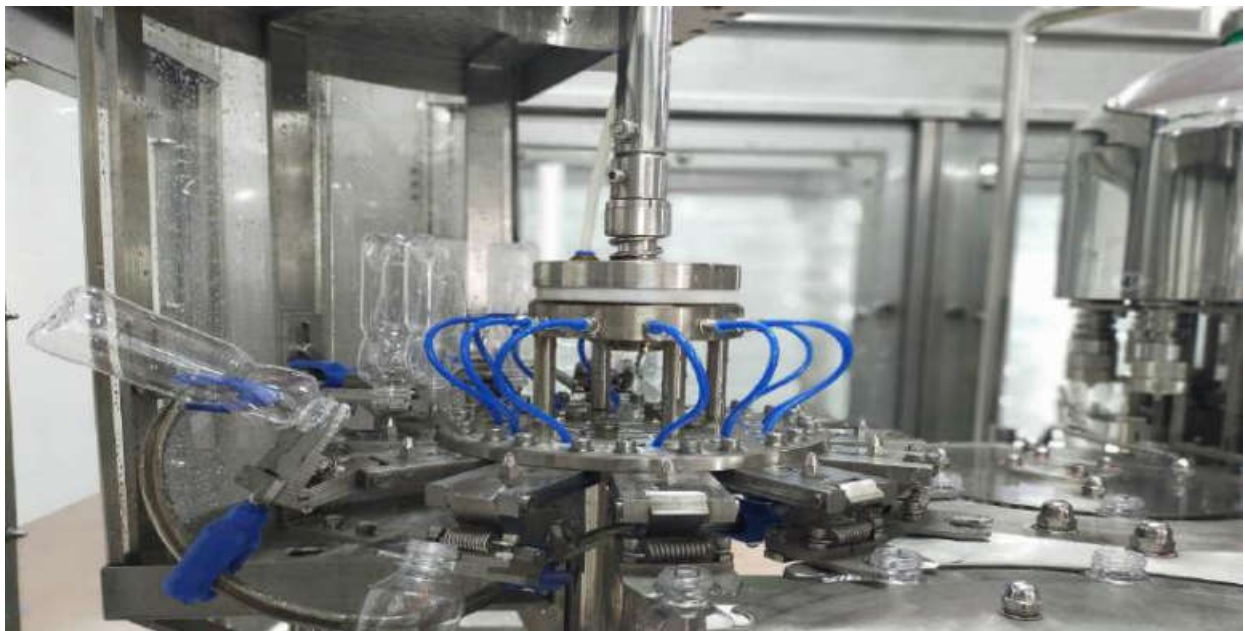
Hệ thống chiết rót chai
